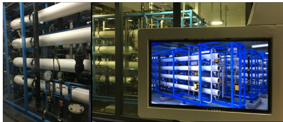
圖 34 先進的逆滲透海水化淡技術 相片來源：規劃署
